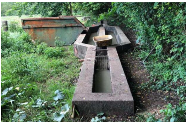
Detalhe do gradeamento, das caixas de areia e Calha Parshall
